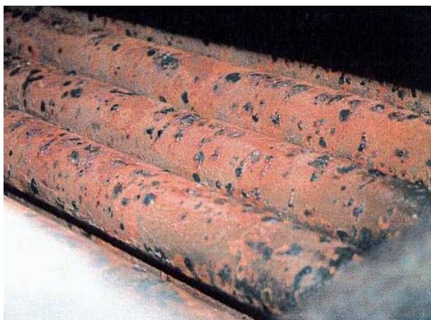
Foto de pitting [corrosión por oxígeno]
