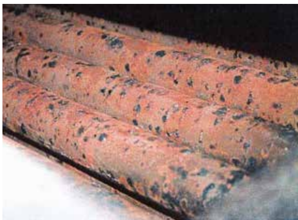
Foto de pitting (corrosión por oxígeno)
