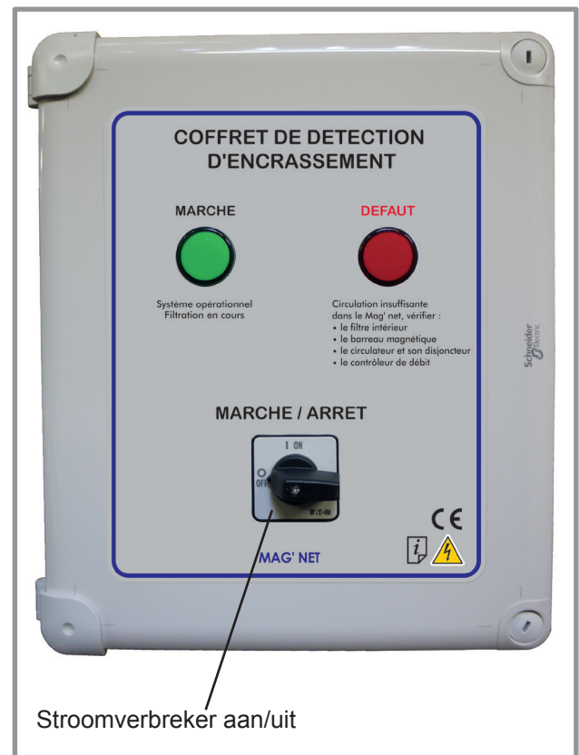
figuur 6 - Stroomverbreker aan/uit
