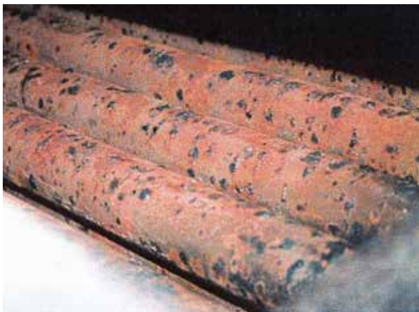
Foto de pitting [corrosión por oxígeno]
