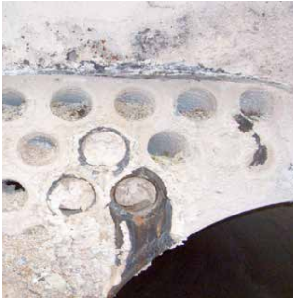
Foto del interior de una caldera donde no se han realizado las operaciones pertinentes de limpieza y purgas.
