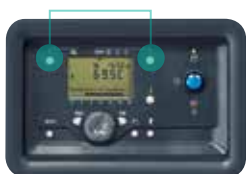
Modification des modes chauffage / ECS
